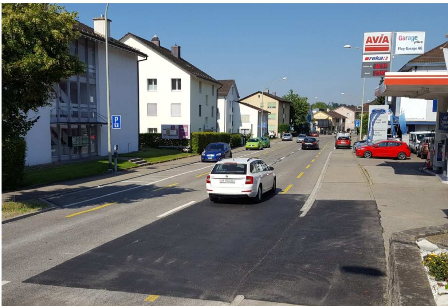
Ein schwarzer Fleck markiert den Ort des letzten Rohrbruchs. Früher als geplant, soll hier auch der Rest der alten Leitungen ersetzt werden. Foto: Christian Wüthrich
